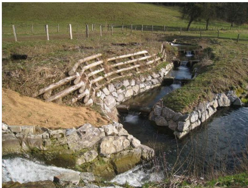
Photo 7 - Aménagement de la jonction fossé / cours d'eau par un renforcement des berges, et une succession de petits seuils dissipateurs d'énergie
